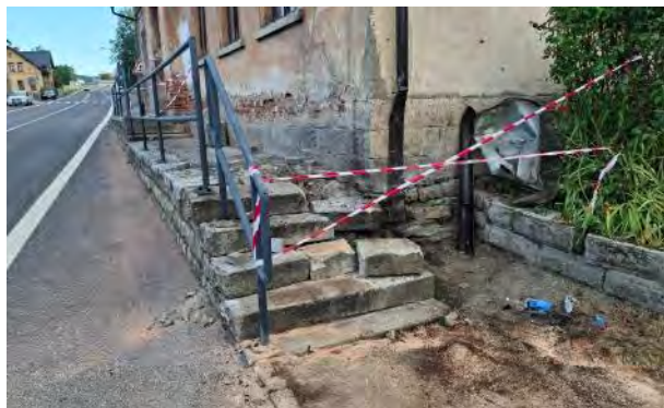
Schody po nehodě
